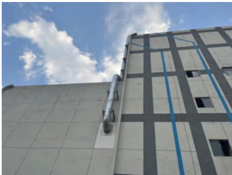
图 4-11 应急排气筒（30m）
