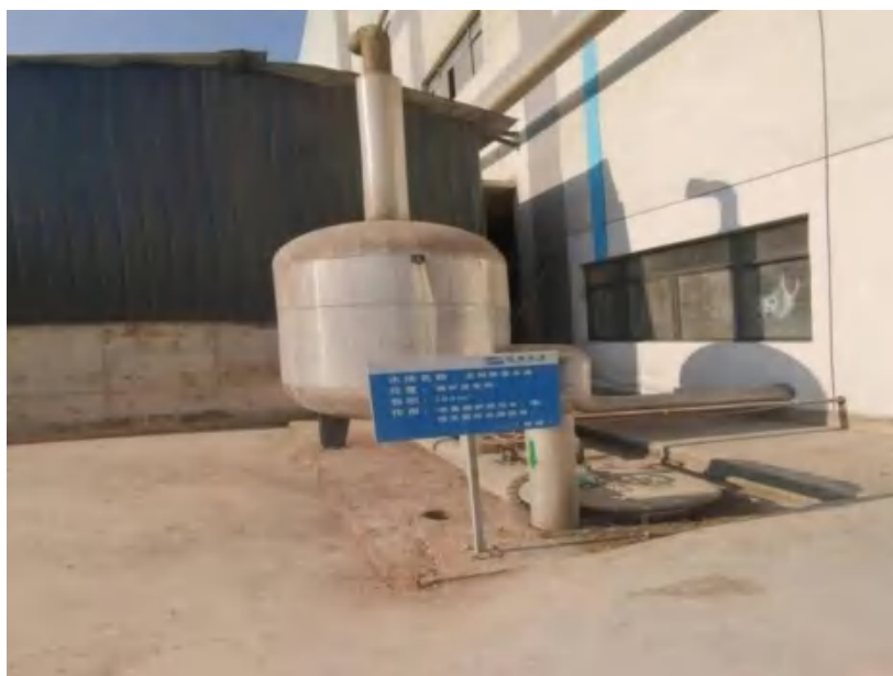
图 4-4 定排降温水池
